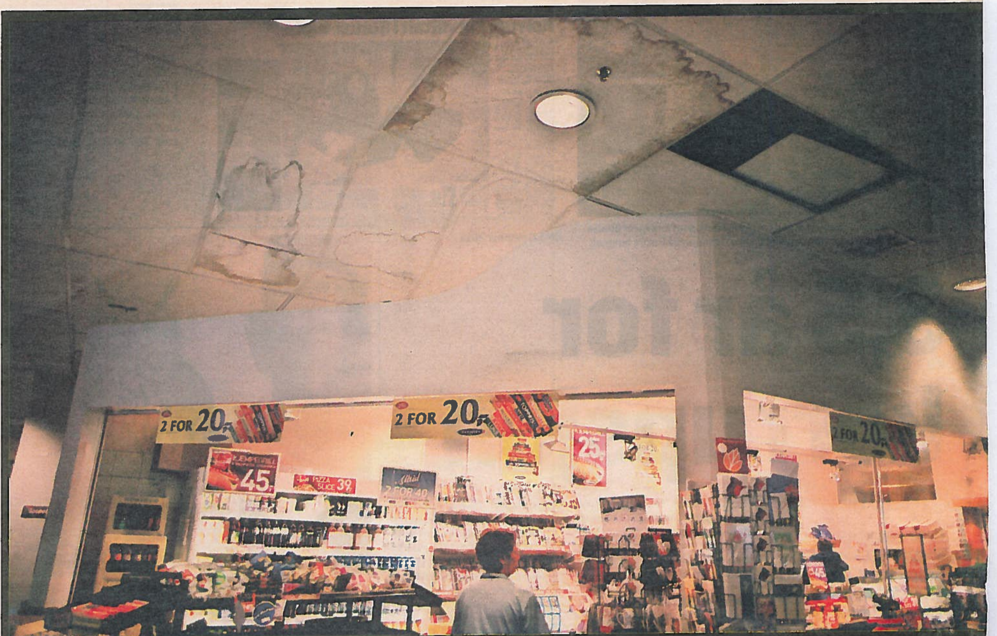
FLEKKER I TAKET. Taket over den nye kantineområdet. Over ligger operasjonsstuen. Alle foto: Javad Parsa
