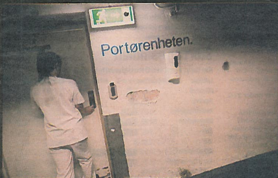
SLITT. Det er hull i veggen flere steder.
